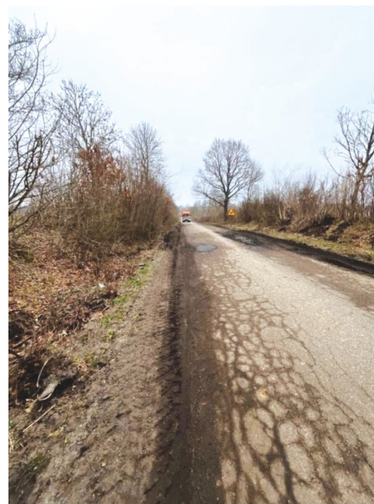
Dokumentacja fotograficzna uszkodzeń drogi powiatowej nr 1430
